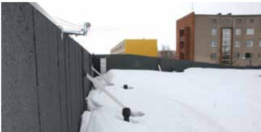
Lumi on katusel sõna otseses mõttes rinnuni. Parapeti kõrgus on enam kui 2 meetrit. Võib vaid ette kujutada, missugune võis lume kõrgus olla detsembris või jaanuaris pärast suuri lumesadusid. Siit võib igaüks ise järeldada, kuivõrd tühised on lompide mõjud katusele. Teostus: OÜ Evari
