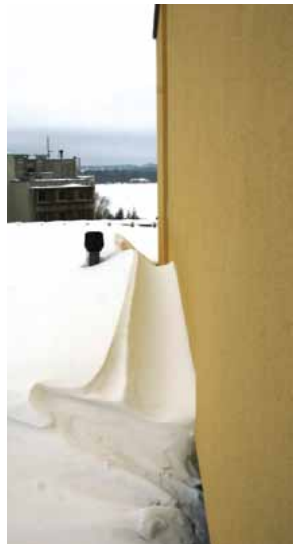
Lumekate üheksakorruseliste tüüp-majade liftišahtide ääres Tallinnas Järveotsa teel 2011. aasta talvel. Teostus: OÜ Katusetark
