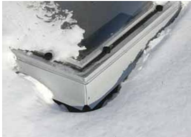
Intensiivse päikese ja hoonesisese soojuse mõjul sulab lumi katuseakna pinnalt isegi miinustemperatuuridel.
