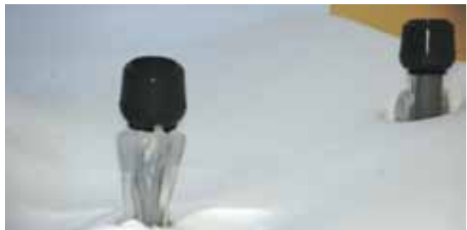
Kanalisatsiooni tuulutuskorstnatele ei tohiks tuuluti kübaraid peale paigaldada. Need võivad talvel jääda ja neist on rohkem kahju kui kasu.
