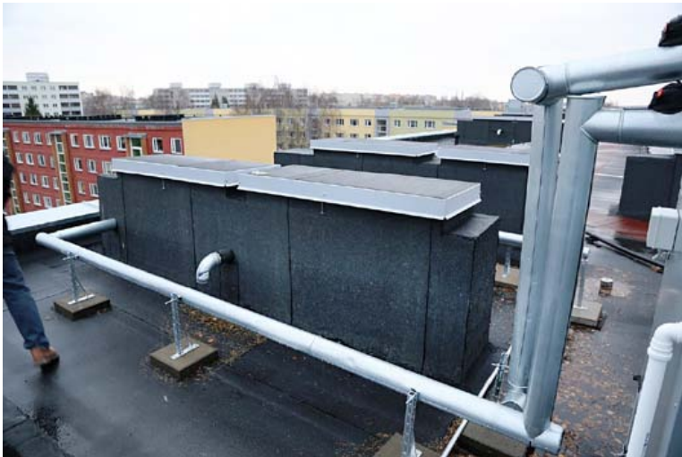
Ventilatsioonišahtid ja ABSi julgestussüsteem
